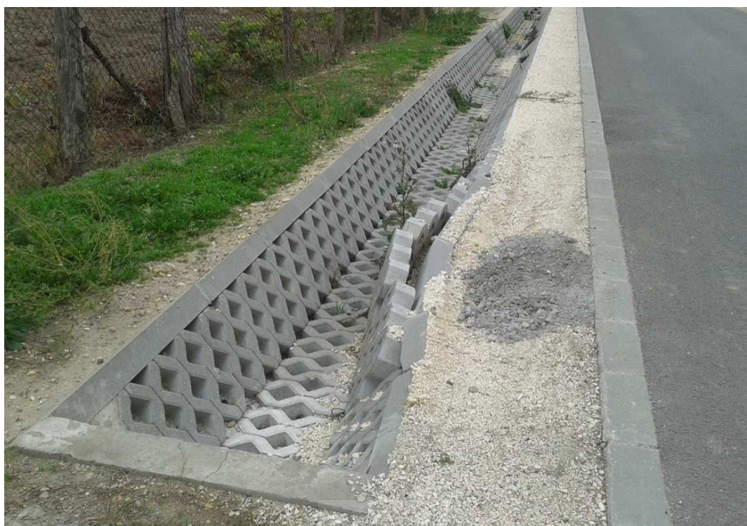
7. ábra Megsüllyedt padka
